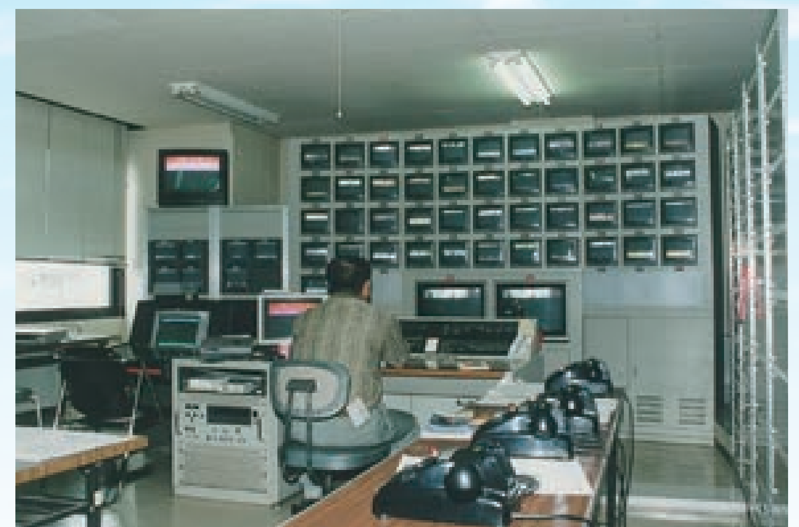
■場内監視カメラ全面改修
