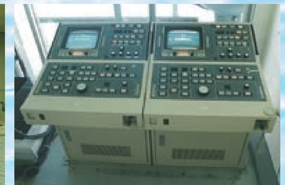
■電子式判定装置導入2重化システム
